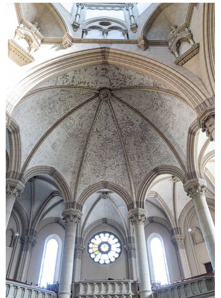
▲ Blick über die historisierenden Bogenstellungen in das Chorgewölbe. Sein Zustand ist restaurierungsbedürftig.
